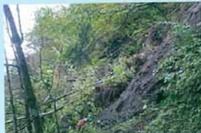
土砂崩れした斜面
