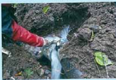
分断された配管
